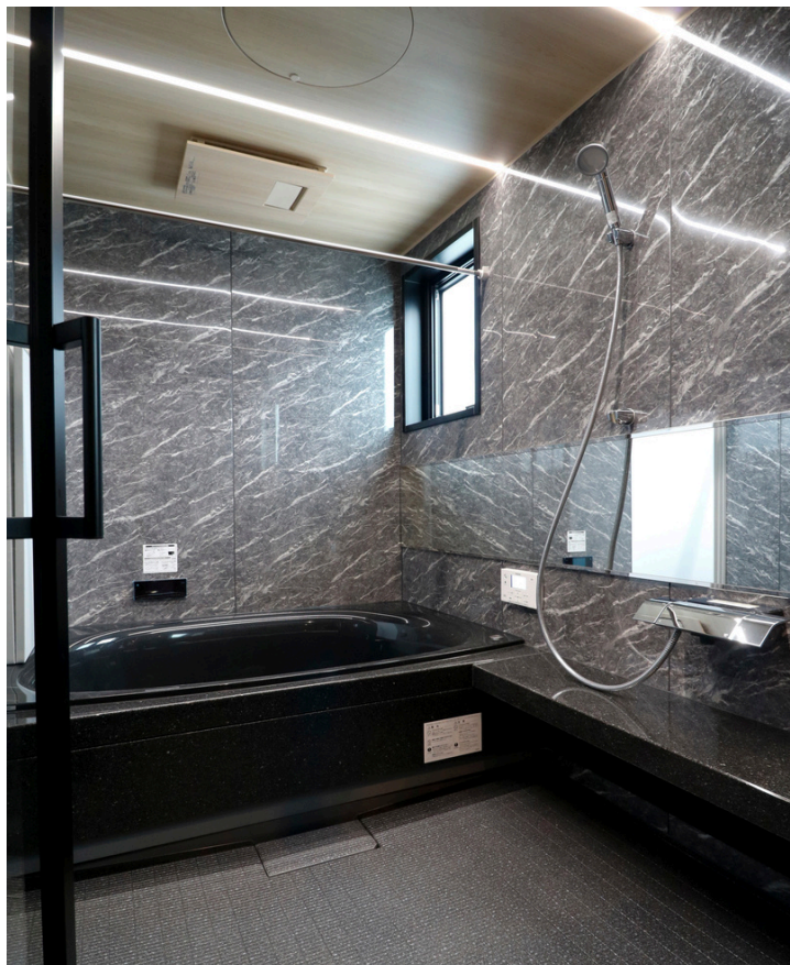
まるでホテルのよう ラグジュアリーな仕様のバスルーム&洗面台
